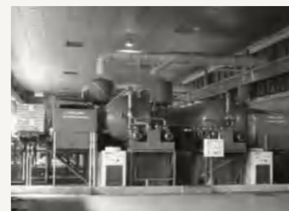
Station de préservation autoclave - Site de production de Moulit (14)
